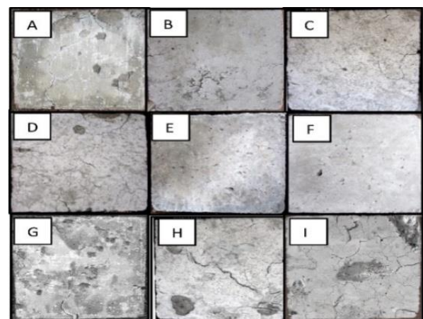
Figure 11. Surface view of specimens: A. M20 CC, B. M20 PPFRC, C. M20 PVAFRC, D. M20 GFRC, E. M20 BFRC, F. M20 CFRC, G. M30 CC, H. M40 CC and I. M50 CC
